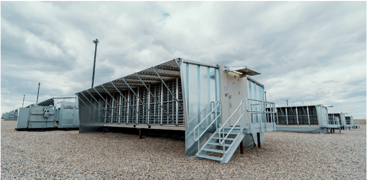
Abb. 3: Bitcoin Mining Rechnerfarm in Medicine Hat, Alberta, Canada im Oktober 2018. Jede Einheit ist mit Lastwagen transportierbar, um Orte mit niedrigem Strompreis aufzusuchen. Hinter den Jalousien sind Ventilatorfelder zur Kühlung der vielen parallel arbeitenden Computer angebracht. Mining ist in der Schweiz nicht rentabel, da der Strom zu teuer ist. (Bild: Curtis Huisman, CC BY 4.0)
