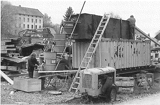
Einfache und dennoch sehr effiziente Dosieranlage für Nährstoffe und Oxidationsmittel. Rechts oben: Ölabscheider; links: Kaskade zur Belüftung des Grundwassers; rechts unten: Tank mit Nährstoffen und Oxidationsmitteln (Bild: Josef Zeyer, ETH Zürich).
